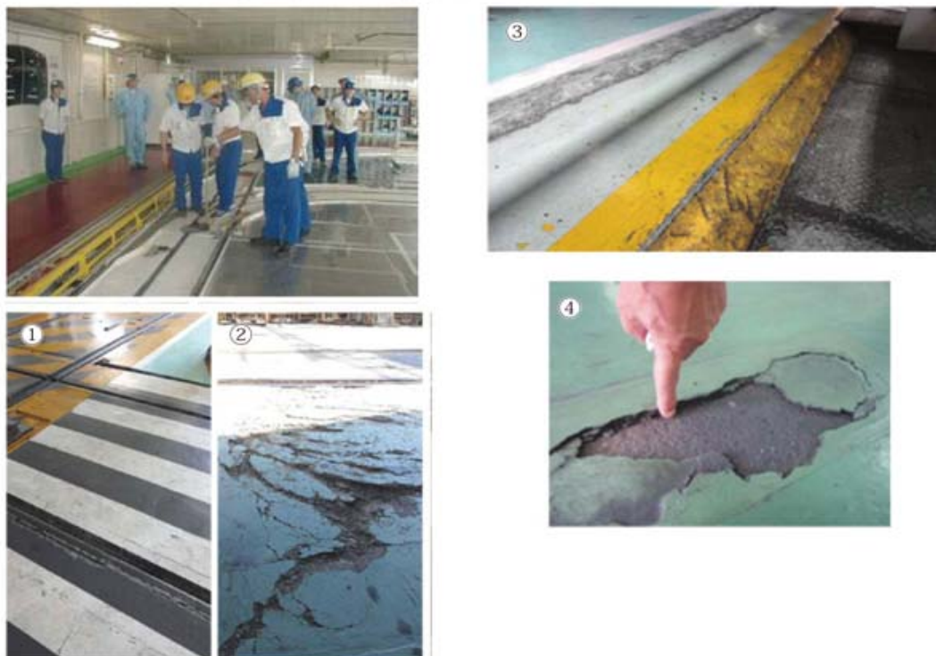
写真1 パトロールの風景と見つかった問題箇所
